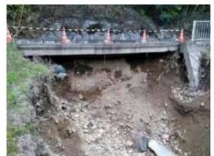
写真1 舗装面を残して滑った舗装のり面（筆者撮影）
